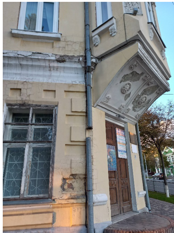
Рис. 12. Состояние фасада дома Лихушина (личный архив)
